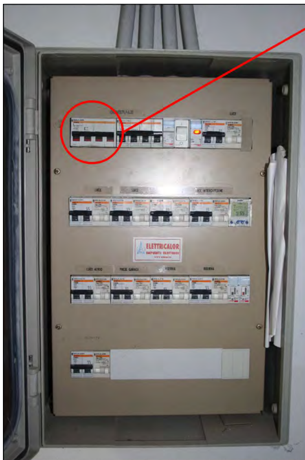
Quadro elettrico Piano Sem.
