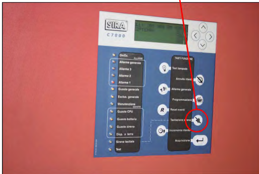
Centrale Rilevazione Incendi
