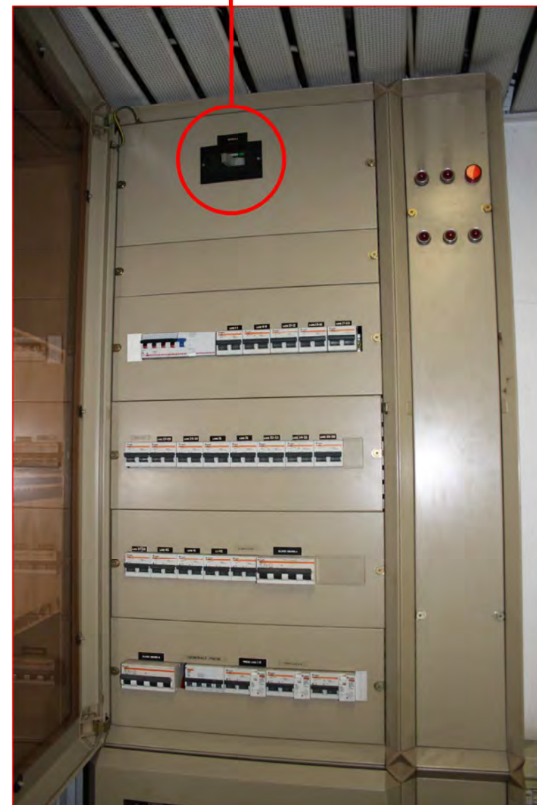
Quadro Elettrico Piano Terra
