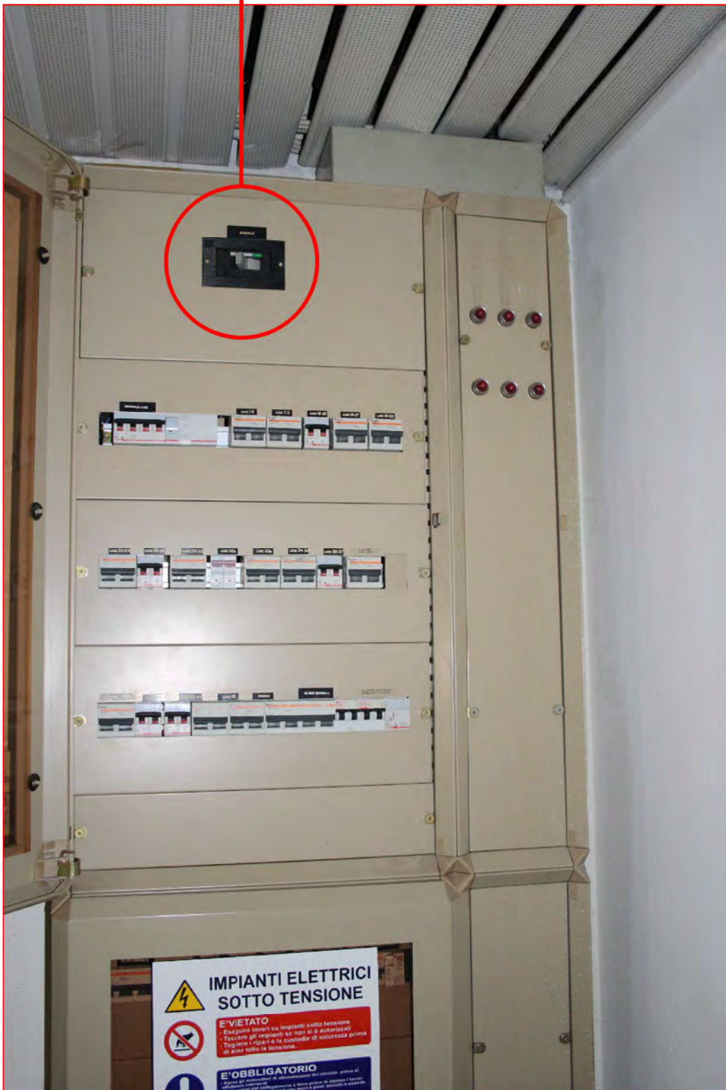
Quadro Elettrico Piano Primo
