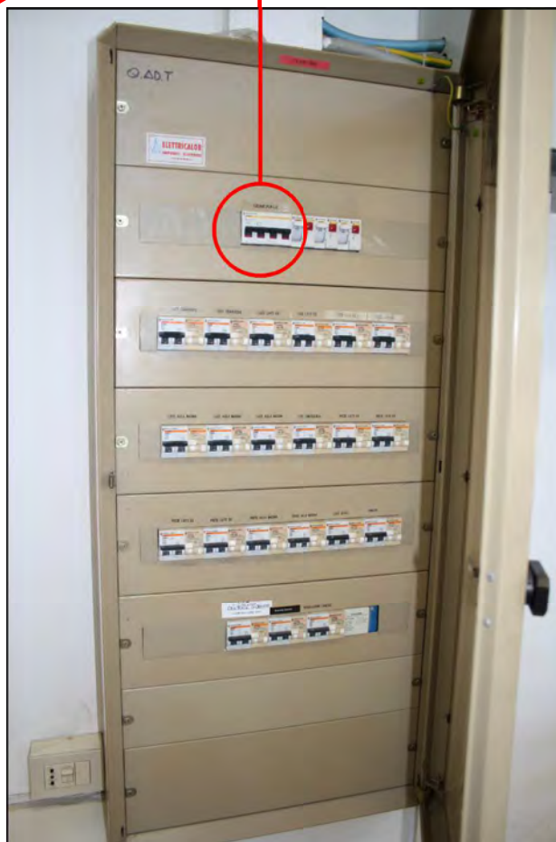
Quadro elettrico Piano Terra
