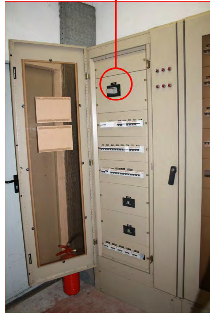
Quadro Elettrico Piano Seminterrato
