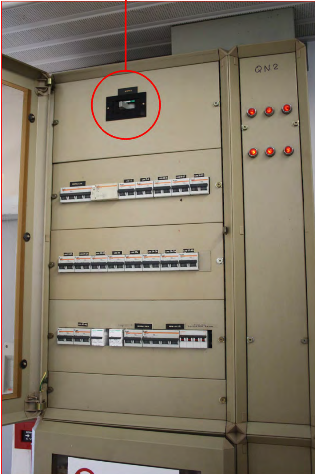
Quadro Elettrico Piano Secondo
