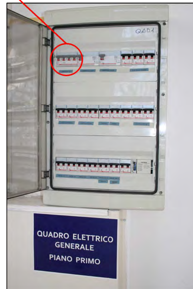
Quadro elettrico Piano 1°
