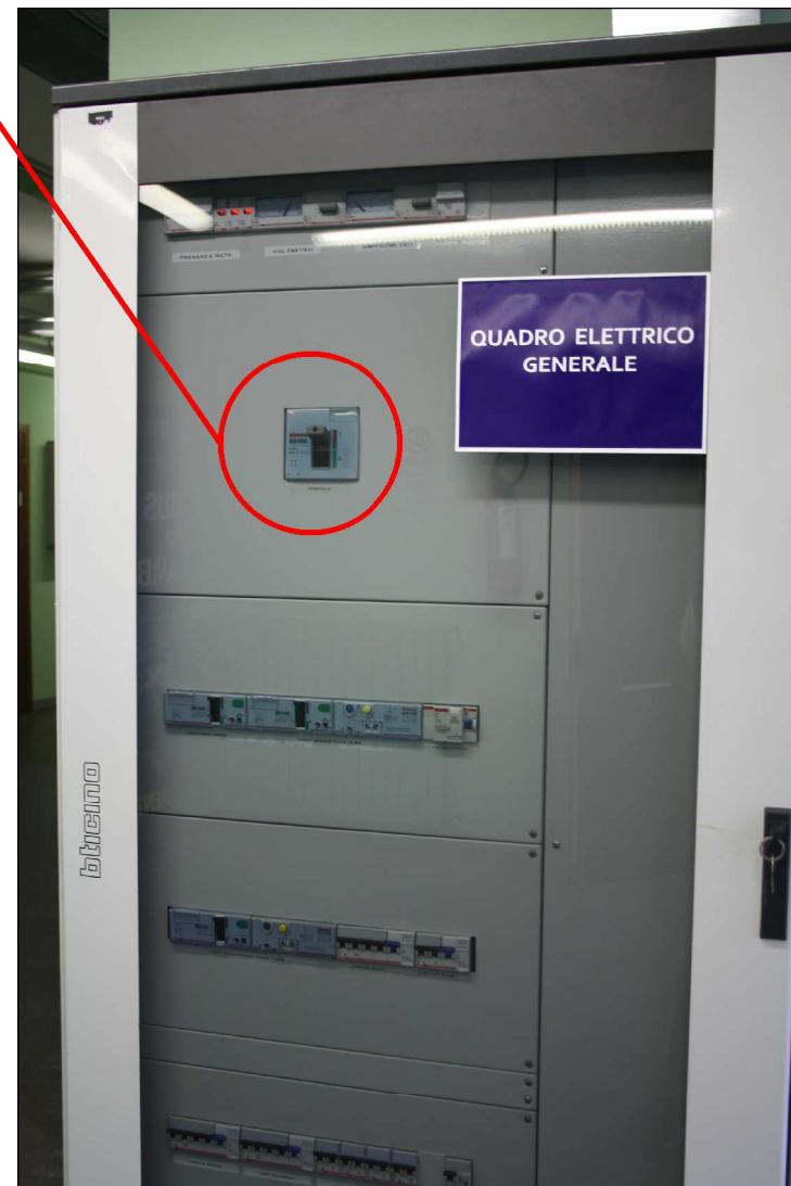
QUADRO ELETTRICO GENERALE + QPT
