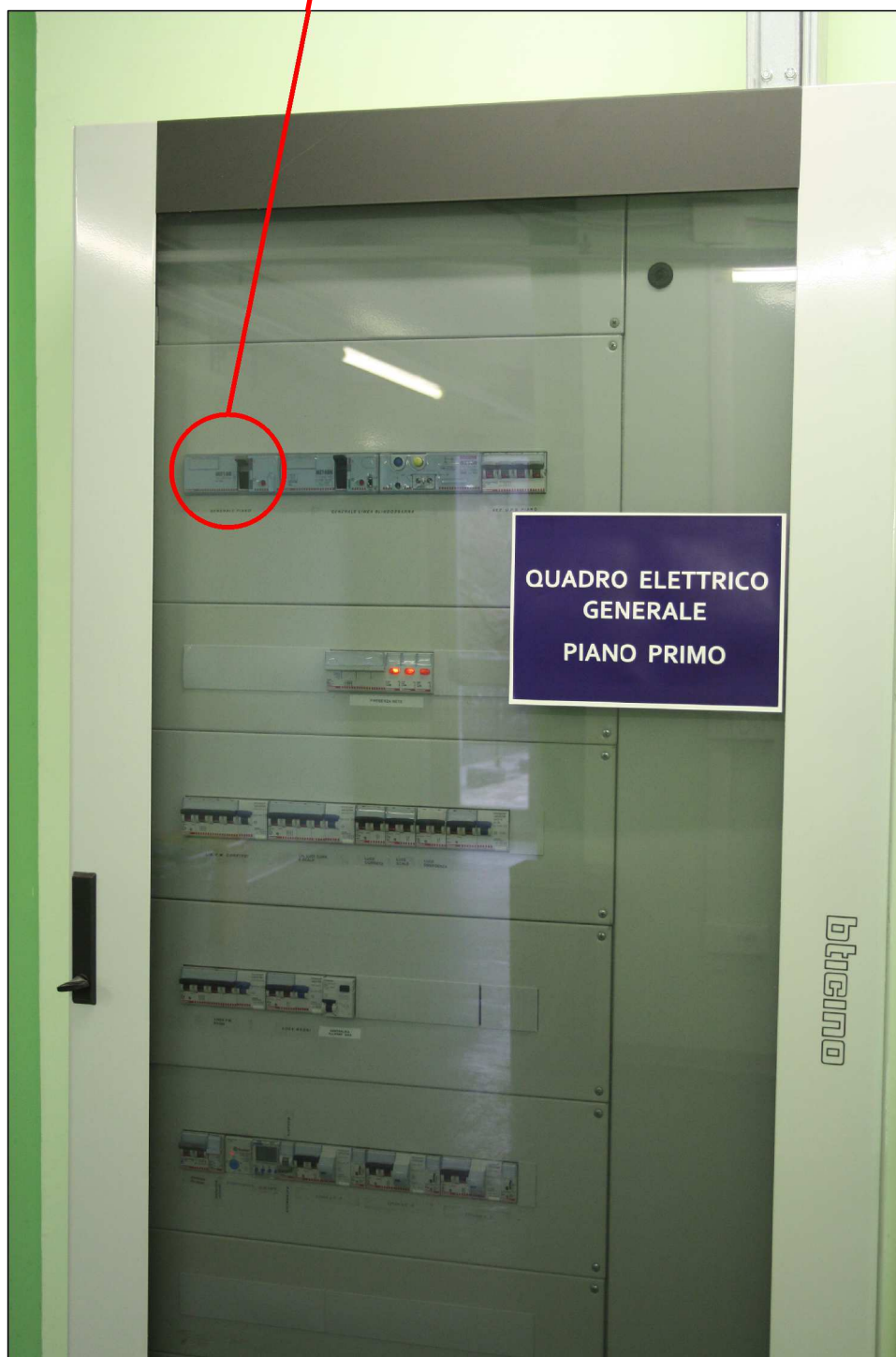
Quadro Elettrico Piano Primo
