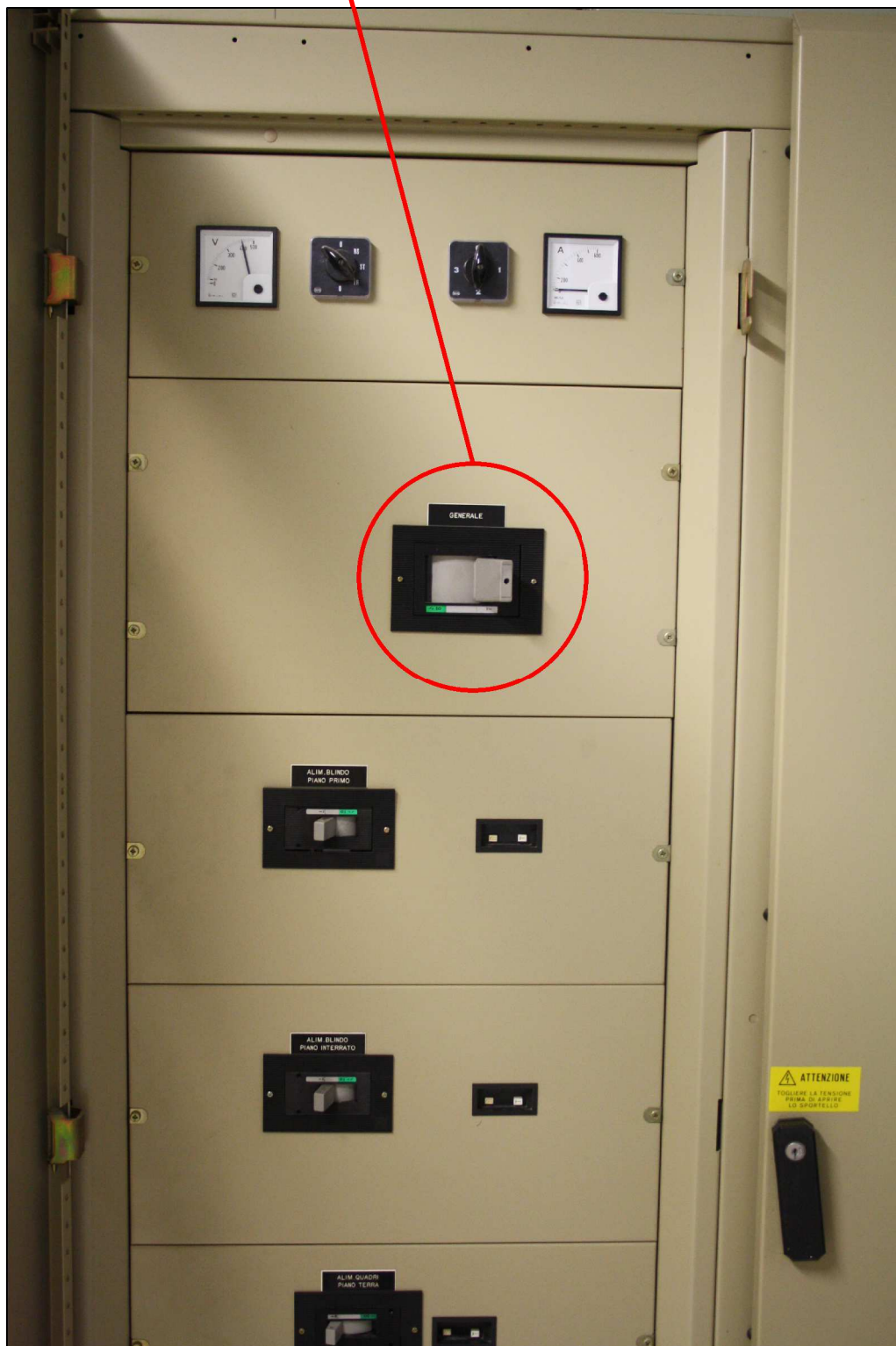
QUADRO ELETTRICO GENERALE + QPS
