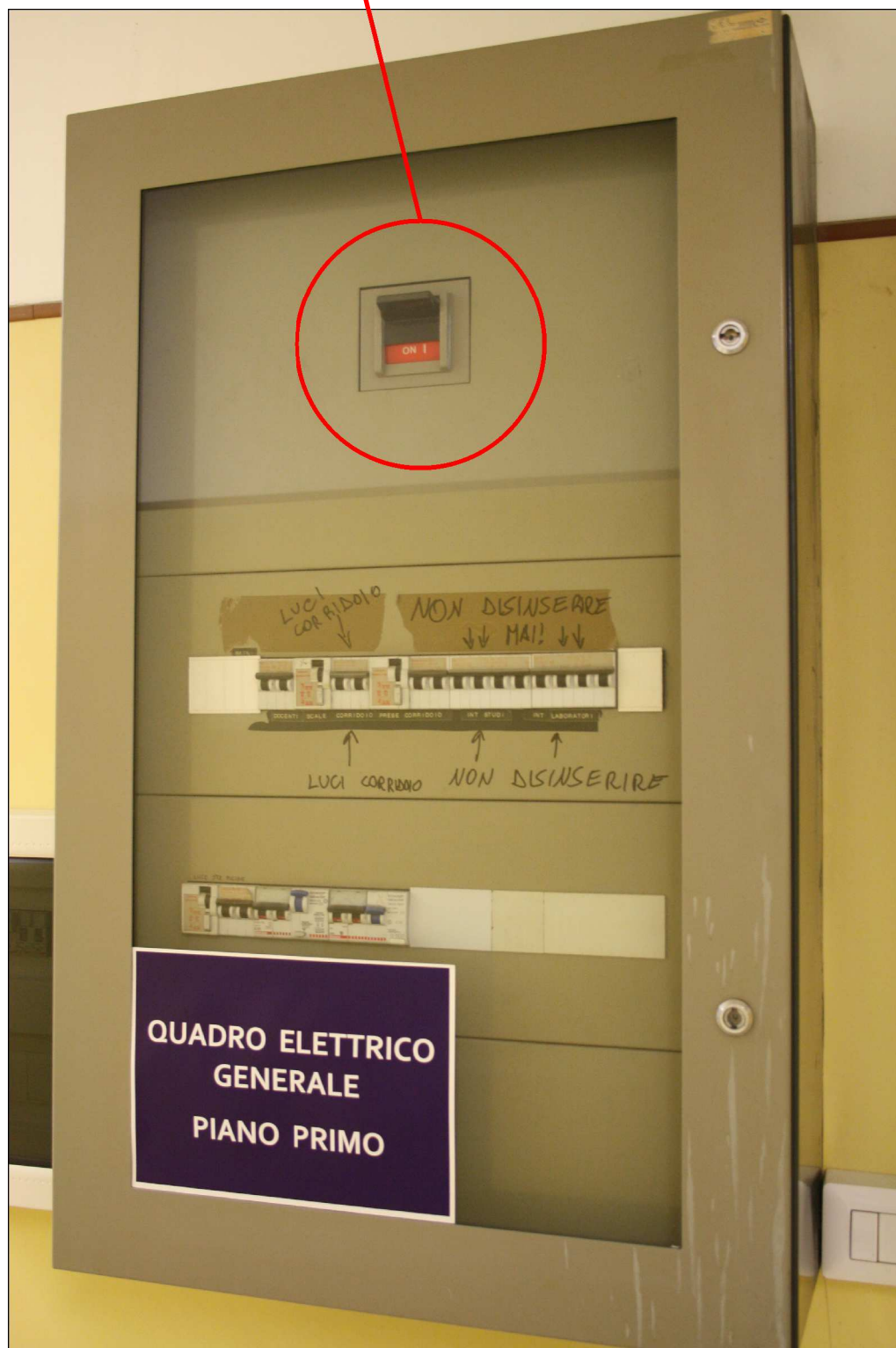
Quadro Elettrico Piano Primo
