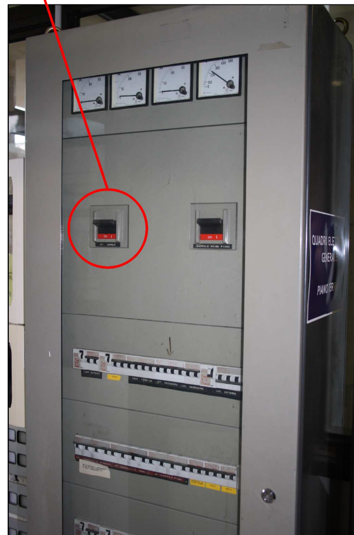
Quadro Elettrico Piano Terra
