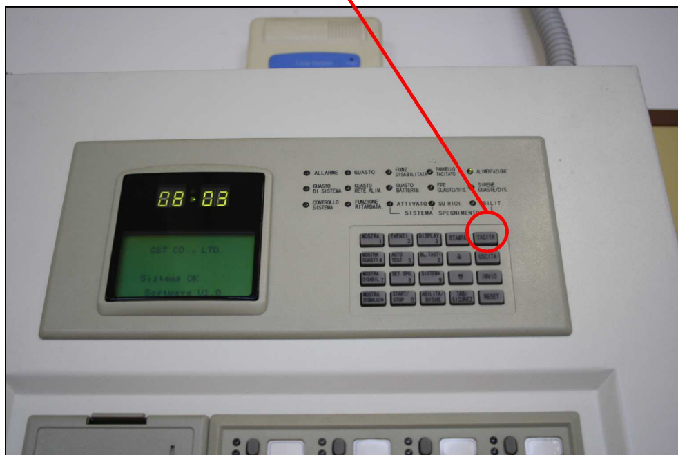
Centrale Rilevazione Incendi
