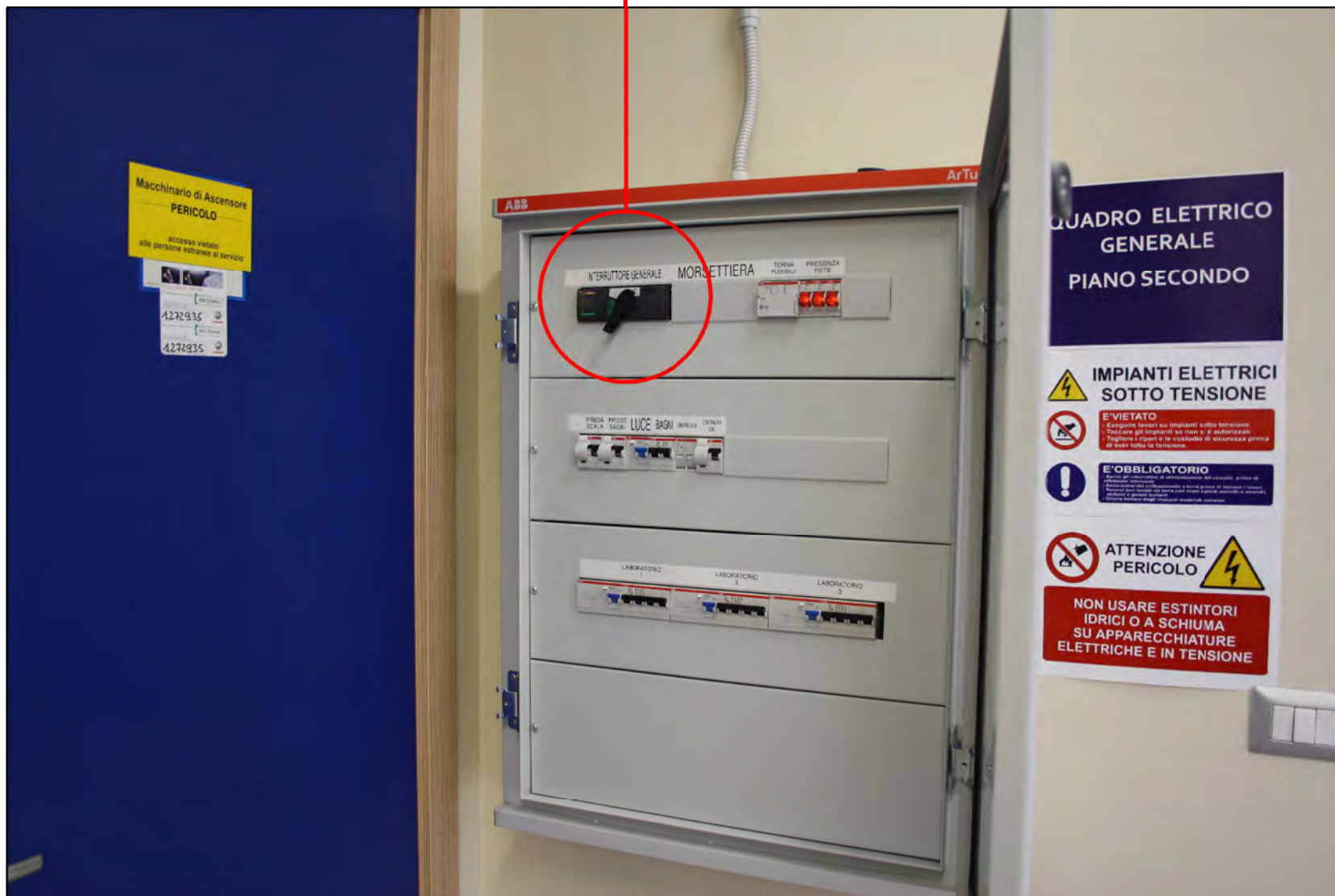
Quadro elettrico Piano Secondo
