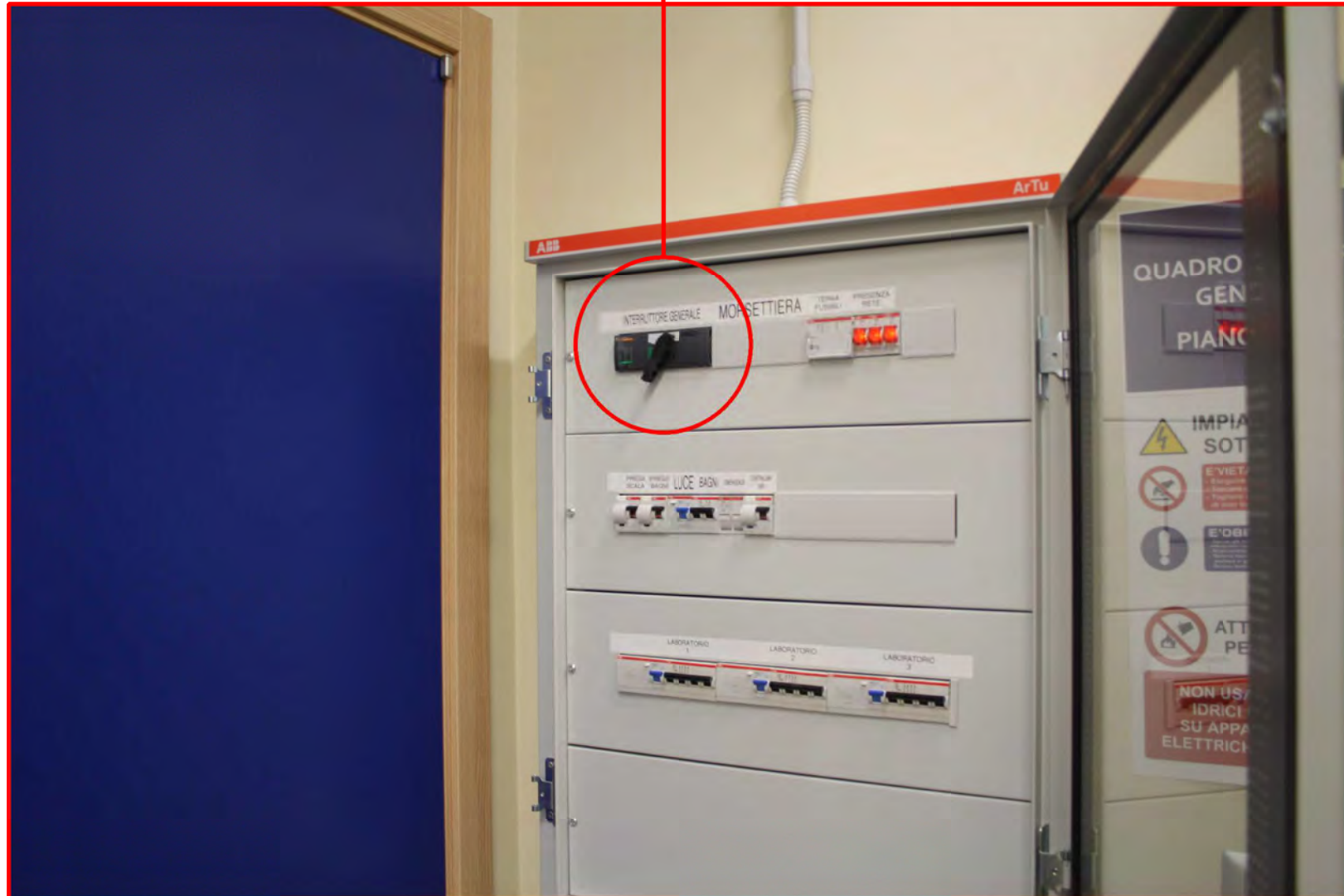
Quadro elettrico Piano Primo
