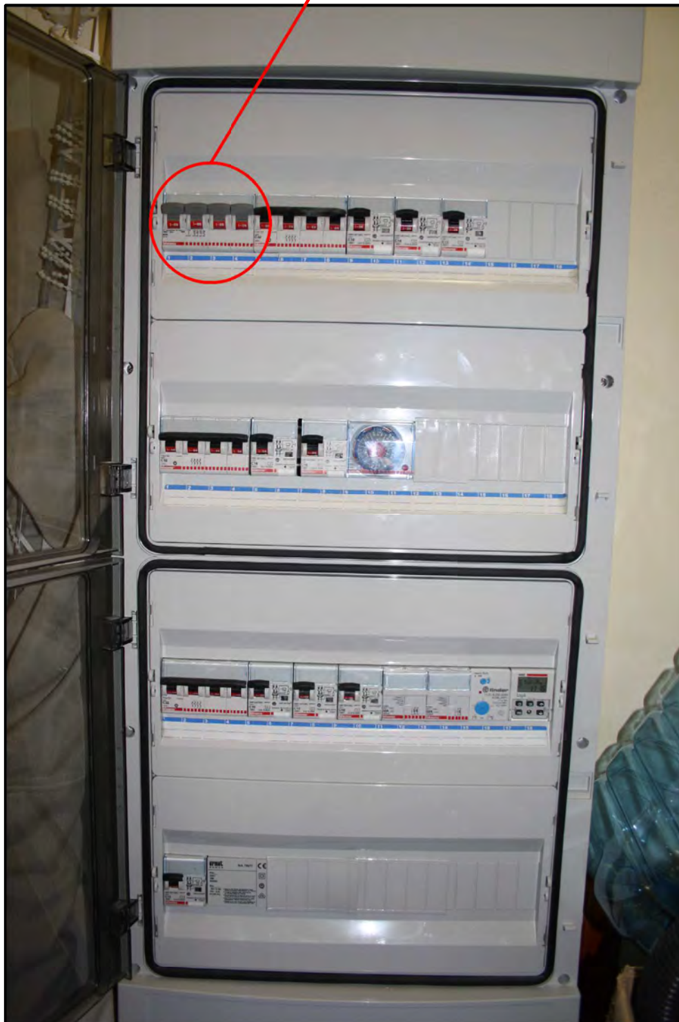
Quadro Elettrico Generale
