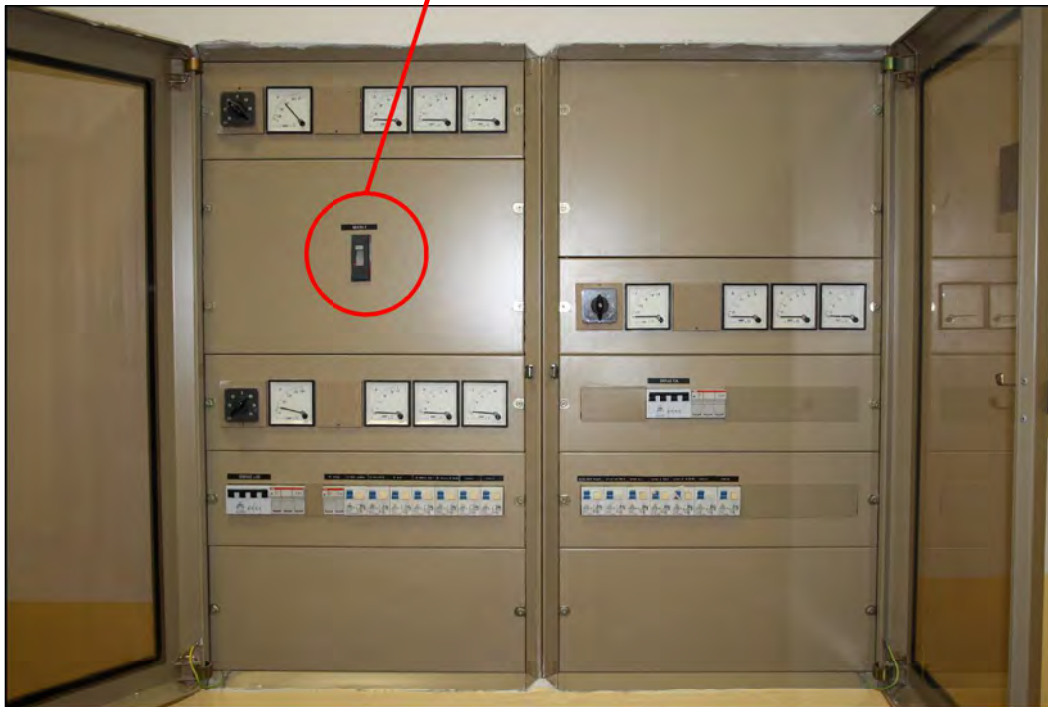
Quadro Elettrico Generale P. 1°
