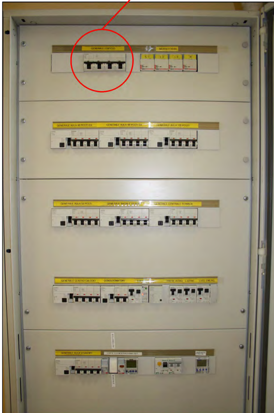
Quadro Elettrico Generale
