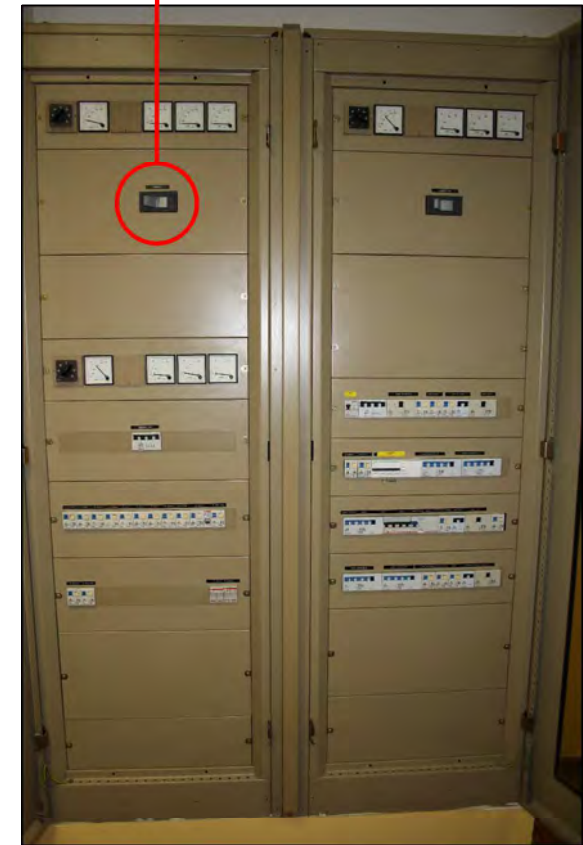
Quadro Elettrico Generale P. 2°
