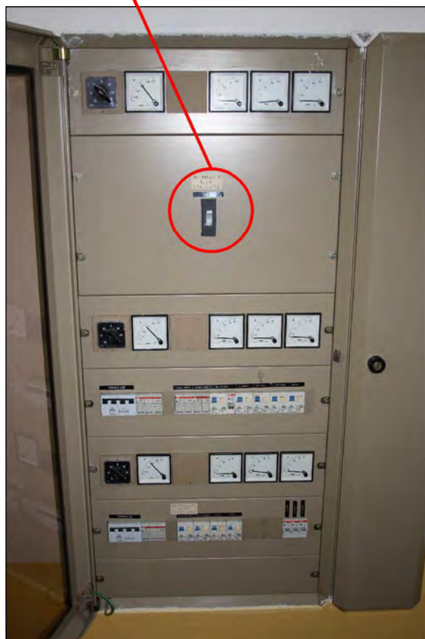
Quadro Elettrico Generale P. Terra
