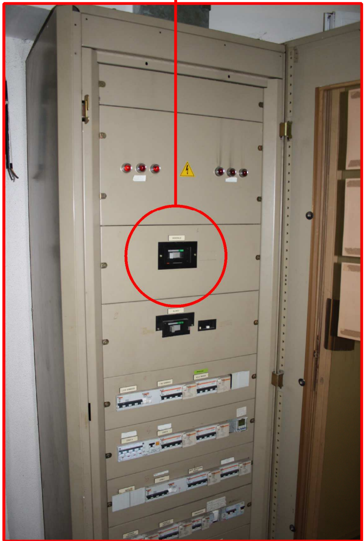
Quadro elettrico Piano Terra
