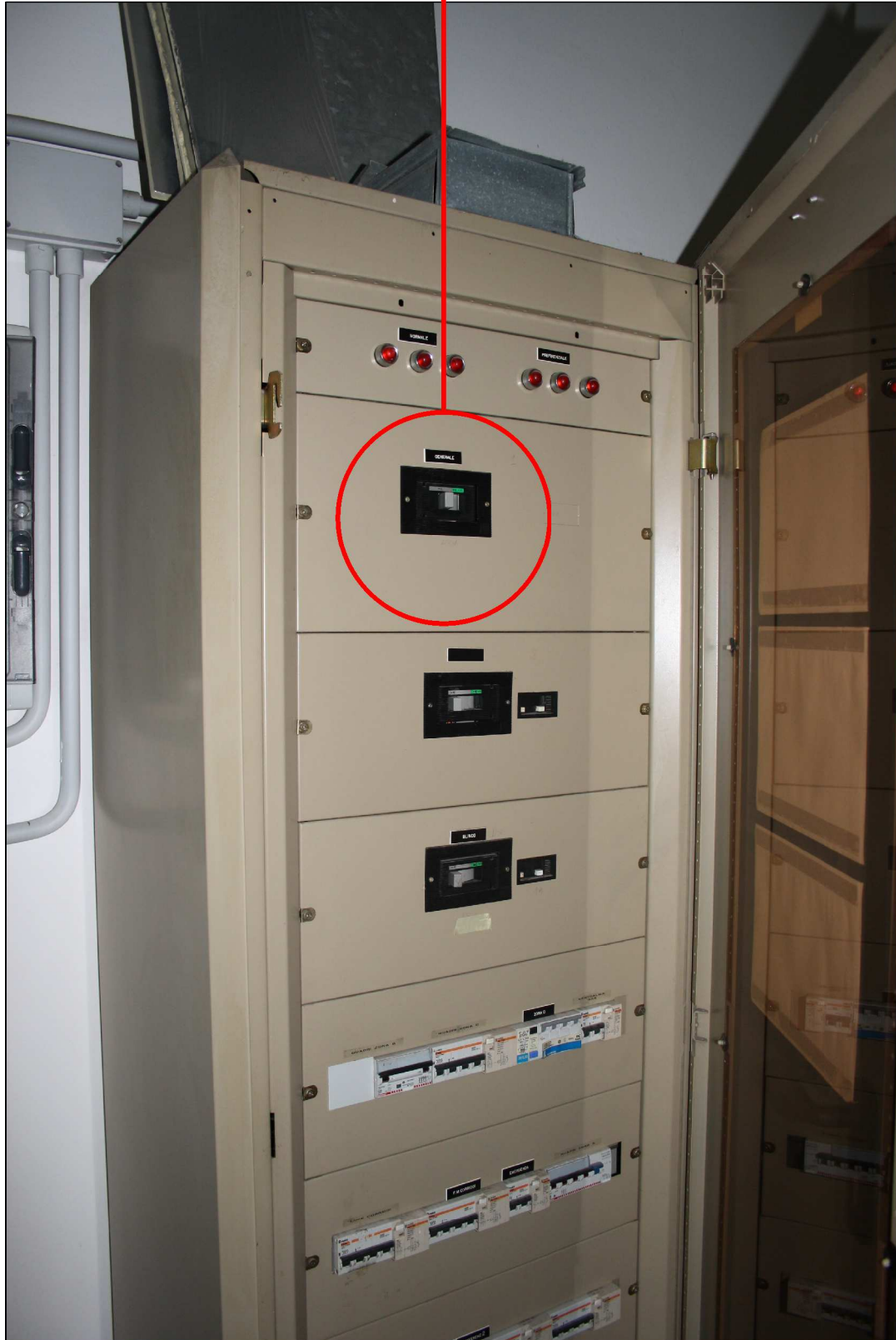
Quadro elettrico Piano Primo
