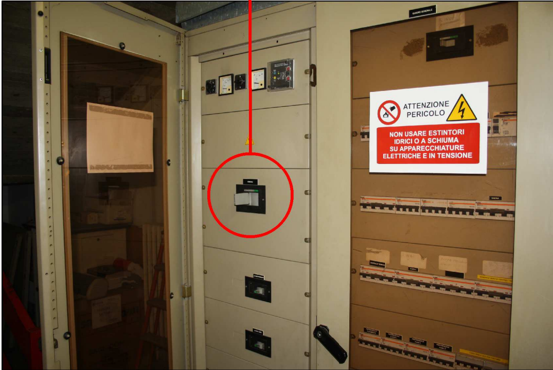
QUADRO ELETTRICO GENERALE
