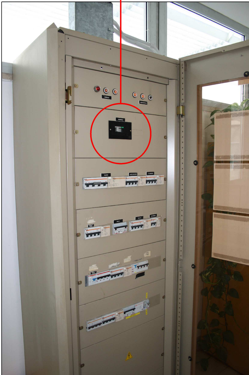
Quadro elettrico Piano Secondo
