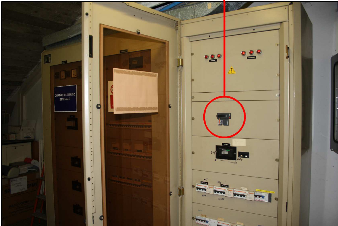
Quadro elettrico Piano Seminterrato
