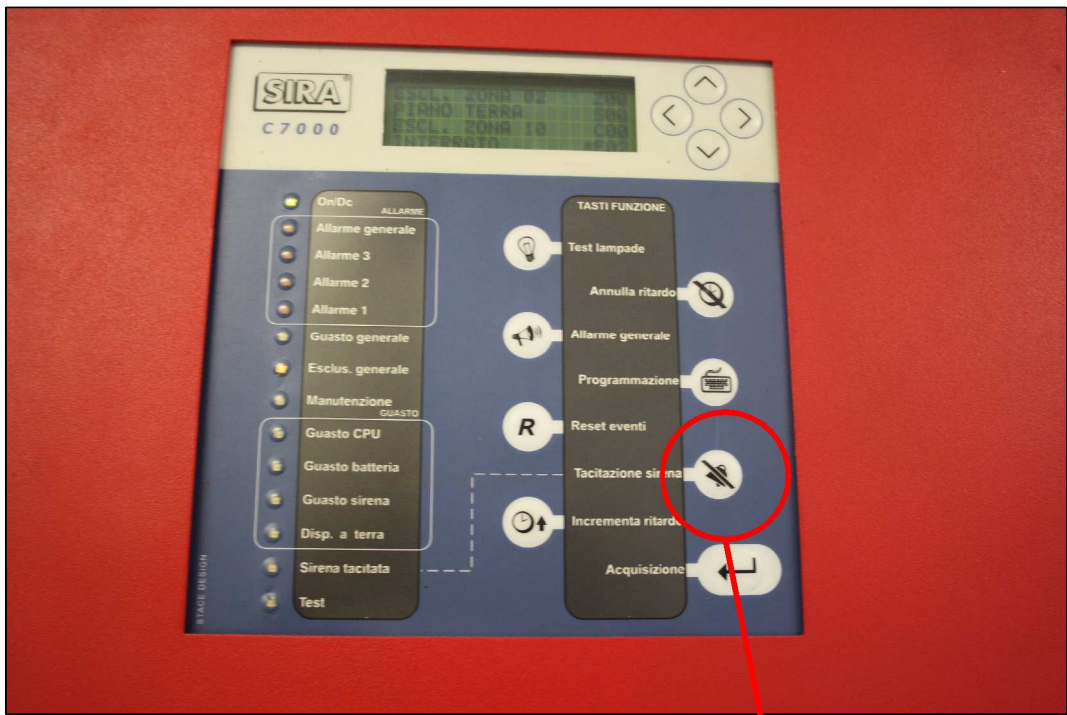
Centrale Rilevazione Incendi
