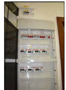
Quadro di zona Q.E.
