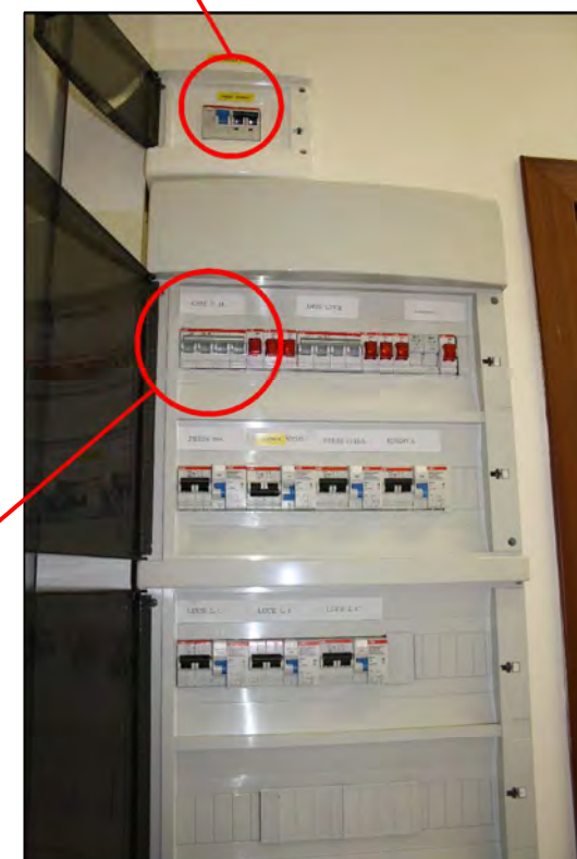
Quadro di zona Piano Terra
