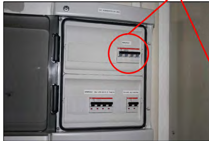
Quadro elettrico UPS
