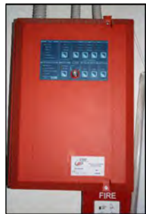
Centrale Rivelazione Incendi
