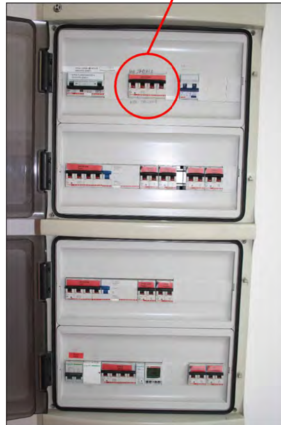
Quadro Elettrico Gen. Aula Bruni (Ex Palestra)
