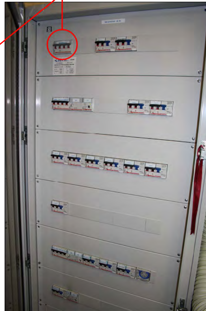
Quadro Elettrico III. Ext.
