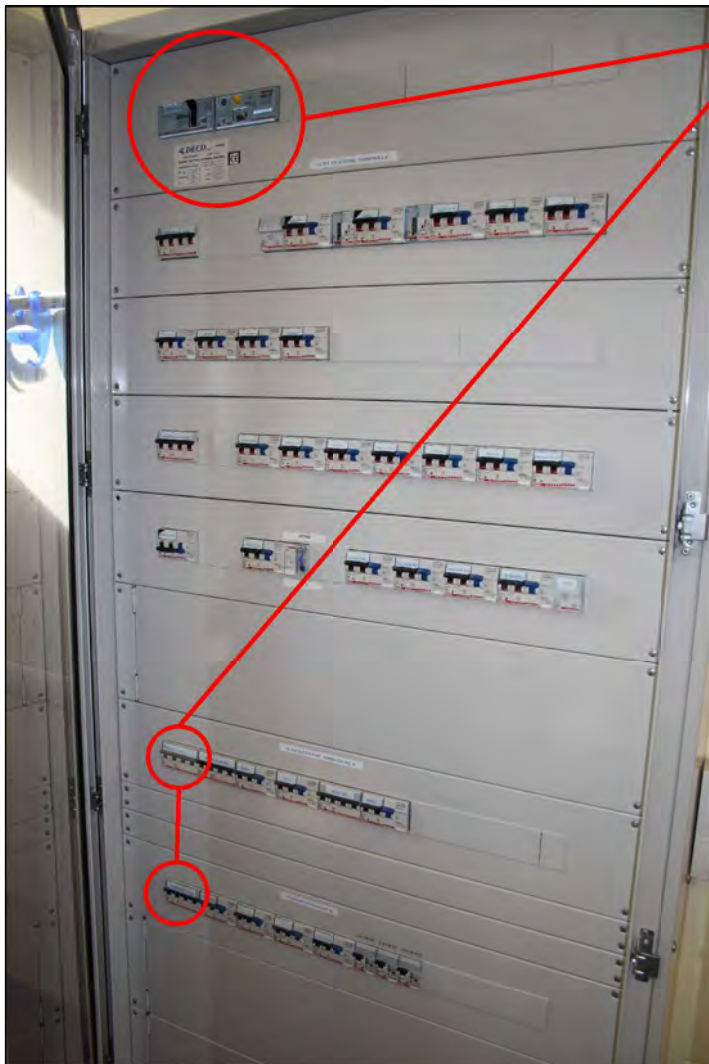
Quadro Elettrico PT zona A
