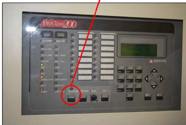
Centrale Rilevaz. Incendi
