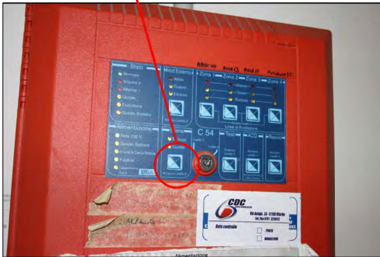
Centrale Rilevaz. Incendi
