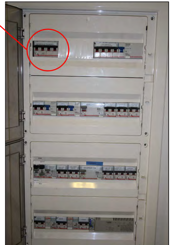
Quadro Elettrico Gen. Aule Ciorba
