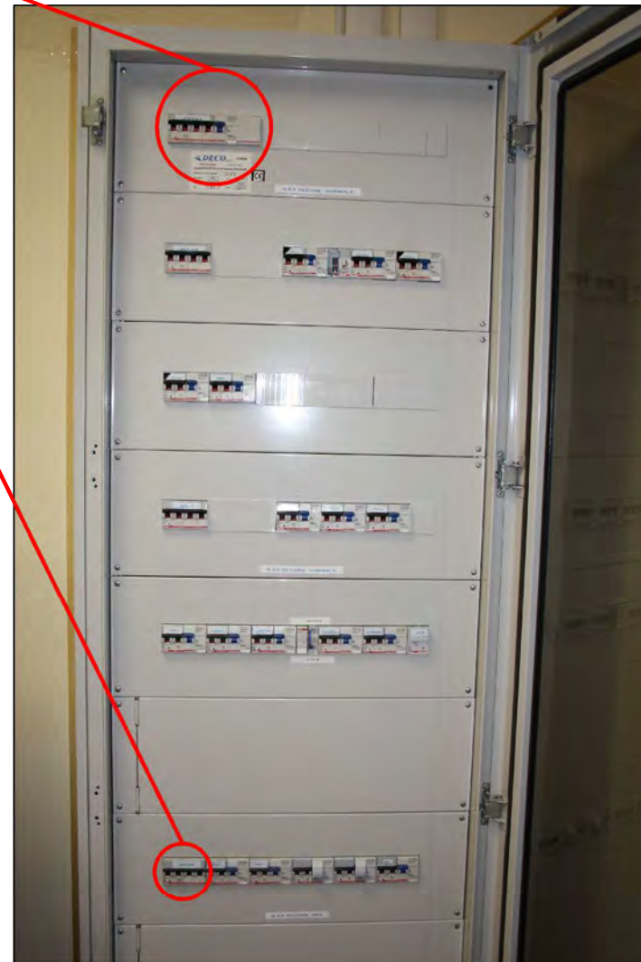
Quadro Elettrico PT zona B
