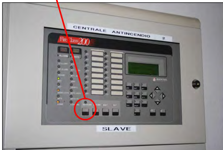
Centrale Rilevazione Incendi
