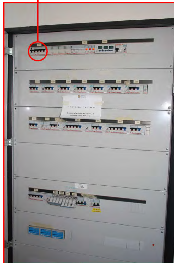
Quadro Elettrico Palco/Sala
