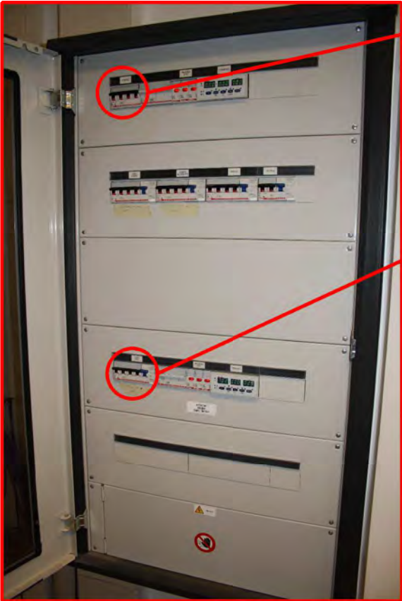
Quadro Elettrico Regia
