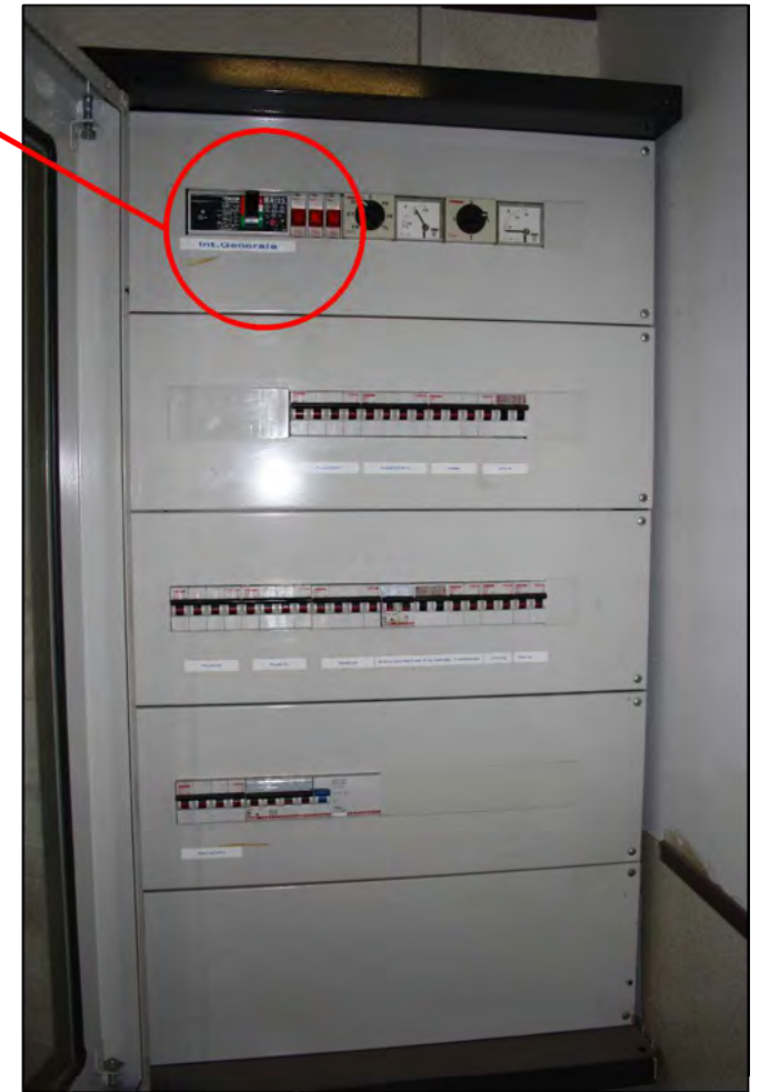
Quadro Elettrico Piano Secondo
