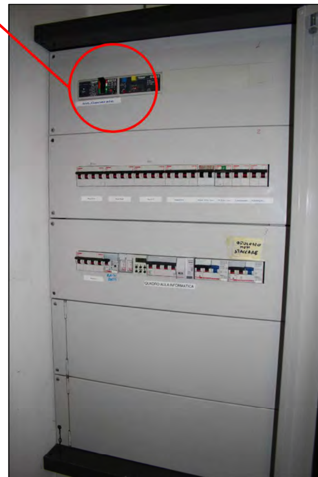
Quadro Elettrico Piano Terra
