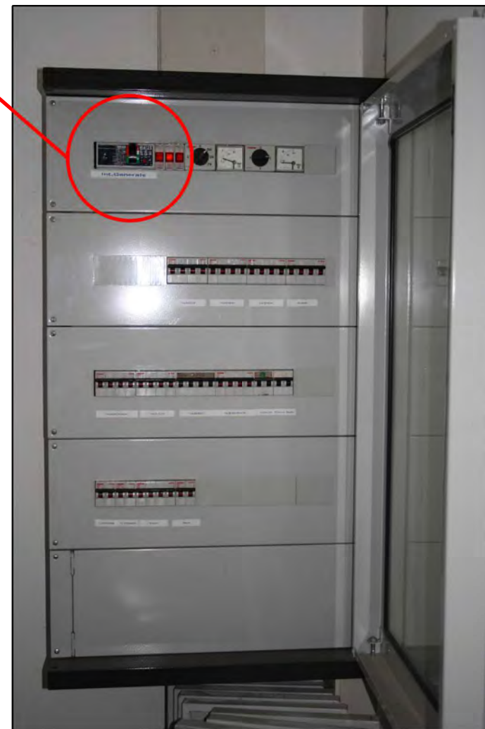
Quadro Elettrico Piano Primo
