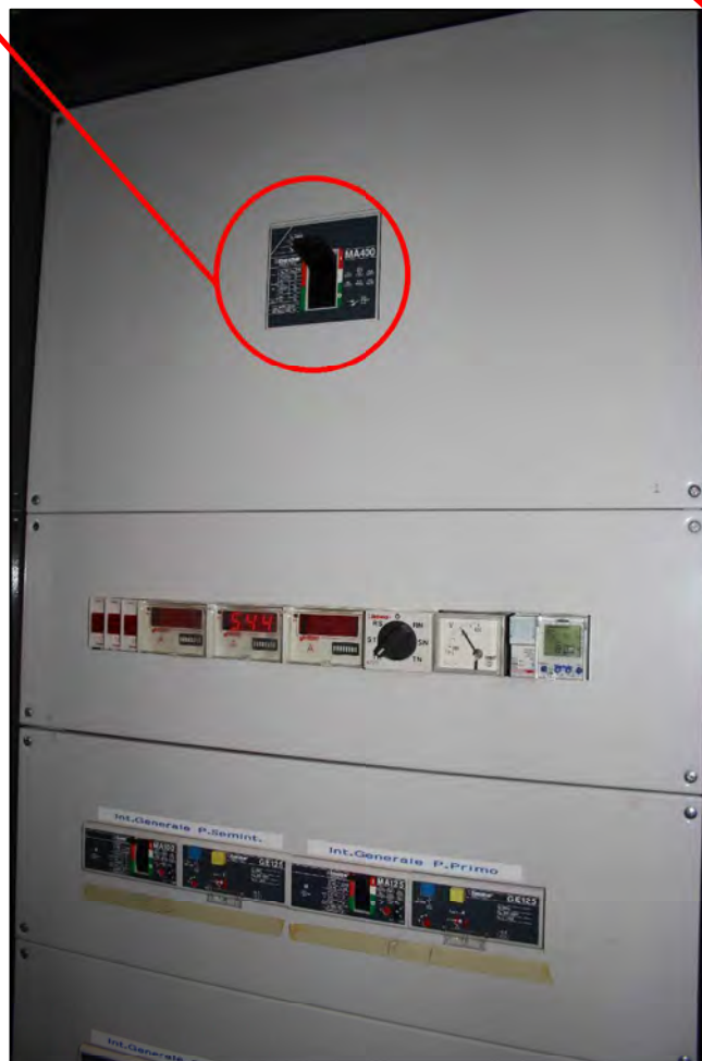
QUADRO ELETTRICO GENERALE
